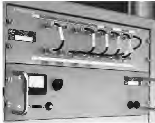
Antennförstärkare NV4 med Antennförväxel
